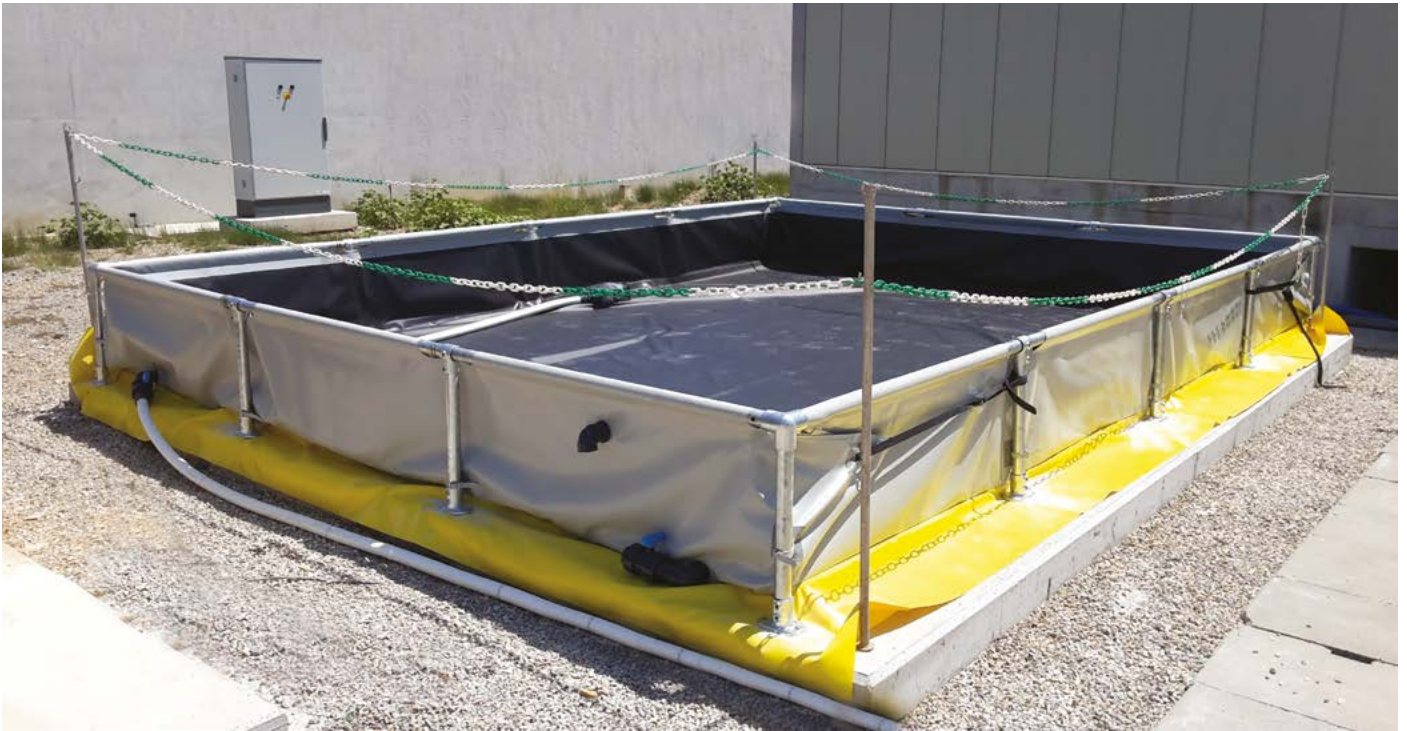
BSTUB : stockage temporaire pour transformateurs électriques immergés
