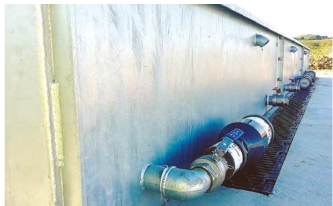
Filtration et évacuation en continu des eaux pluviales (installations extérieures)
